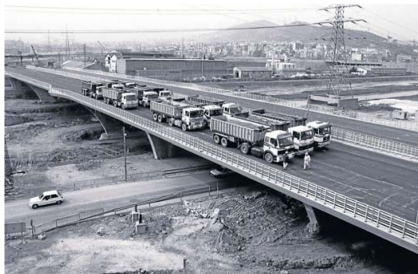
Operaris fent una prova de càrrega sobre el pont del riu Besòs durant la construcció de la pota nord del Segon Cinturó el març del 92. LLUÍS GENÉ / EFE
